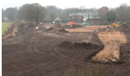
Auf dem Baufeld Osdorfer Born wird der Oberboden abgeschoben. Am rechten Bildrand ist die gelbe Siebanlage zu erkennen.
