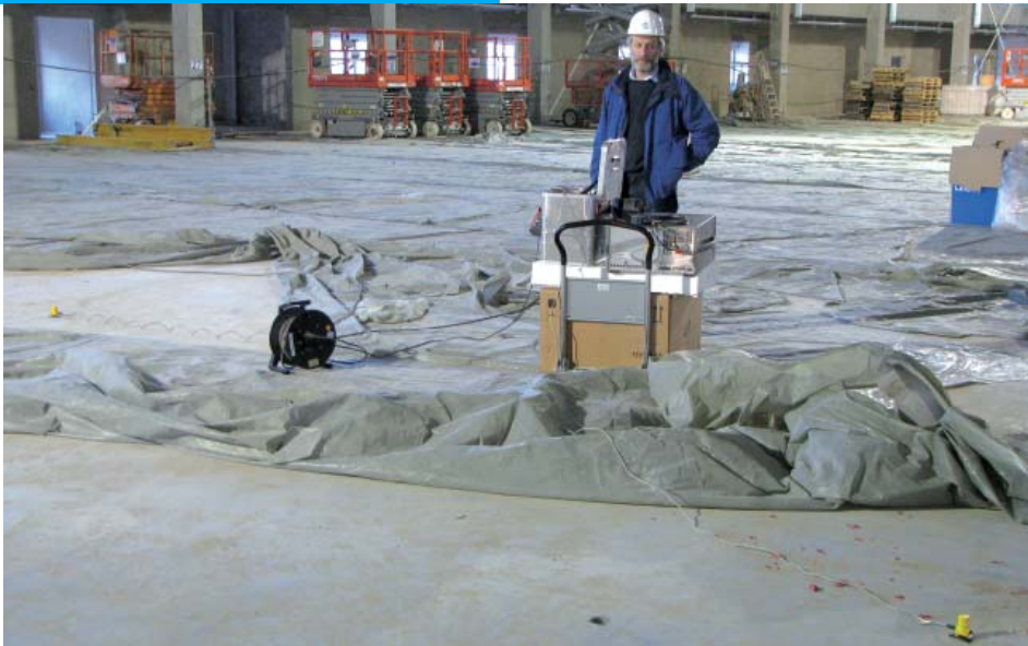
Winzige, gelbe Messfühler (z. B. unten rechts) zeichnen Vibrationen auf. Geht ein Mensch in zwei Meter Abstand an ihnen vorbei, bleibt die Deformation der Betonplatte unter einem Mikrometer – genau wie geplant.
