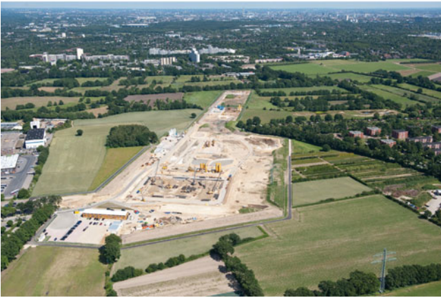
Abbildung 19: Das große Baugelände des European XFEL südlich der Stadt Schenefeld südöstlich in Richtung von DESY gesehen.
