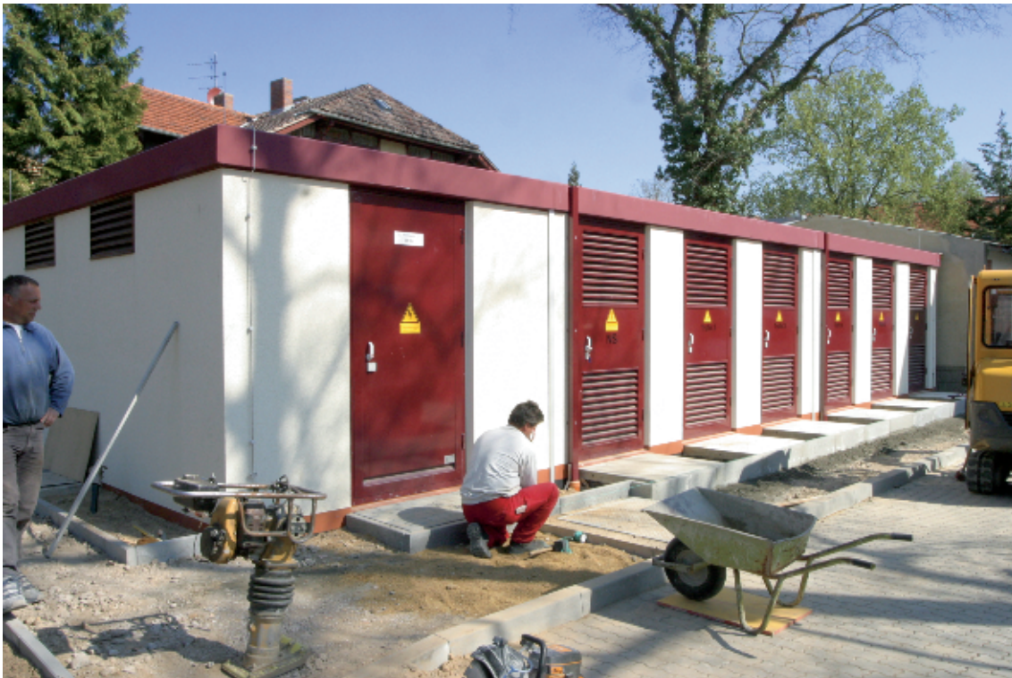
Abbildung 145: Die neue Stromspeisung mit 20 kV Station.
