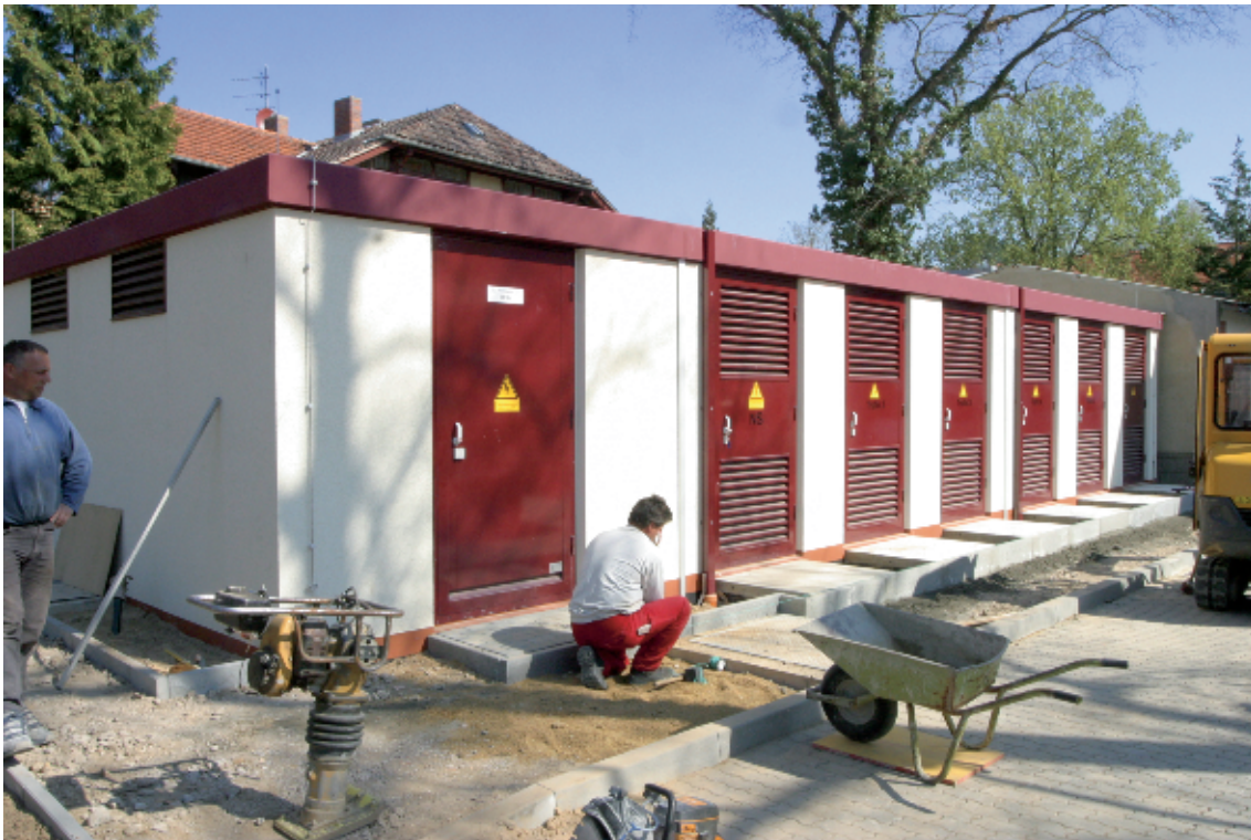
Abbildung 145: Die neue Stromeinspeisung mit 20 kV Station.
