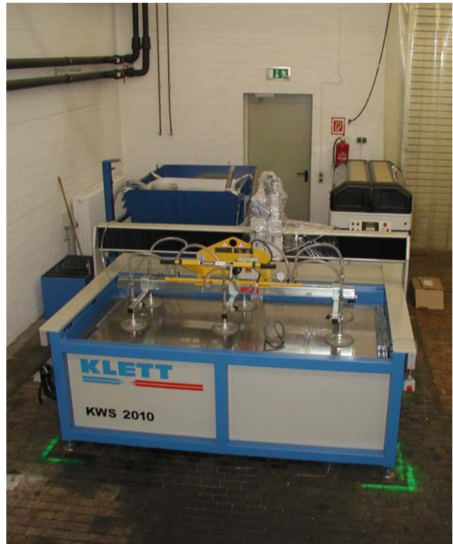
Abbildung 143: Wasserstrahl-Schneidanlage in der Hauptwerkstatt.
