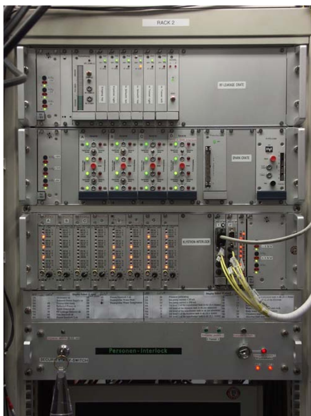
Abbildung 107: Rack mit Steuerelektronik für das Klystron-Interlock
