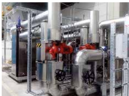
Diese Wärmeübertrager in der Kältehalle speisen die Wärme der Kryoanlage ins Fernwärmenetz ein.
