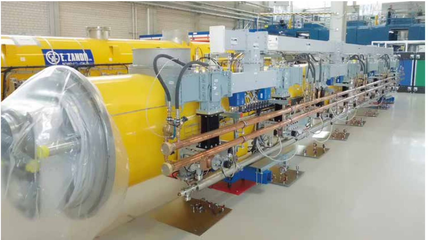
European-XFEL-Beschleunigermodule im gelben Tank mit vollständig montierter maßgeschneiderter Hohlleiterversorgung.
