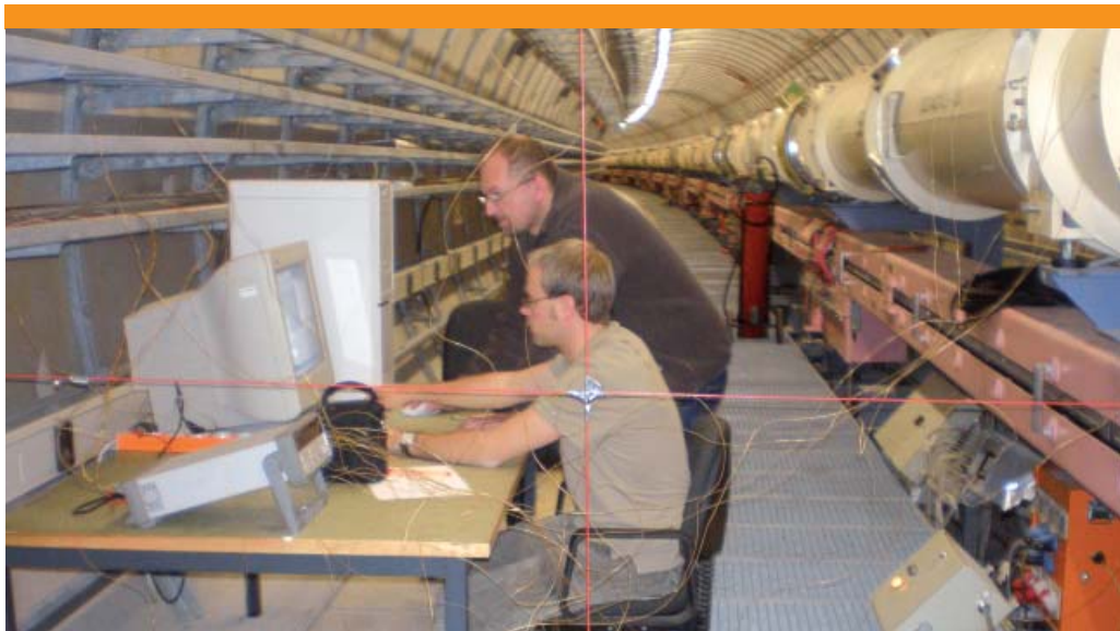
Wissenschaftler der Universität Stuttgart prüfen die Funktionen der Temperatursensoren, die an roten Drähten (im Vordergrund) im HERA-Tunnel aufgehängt sind.
