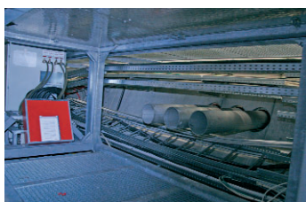
Die Verbindungsrohre zwischen dem neuen Gebäude und dem Tunnelinneren
